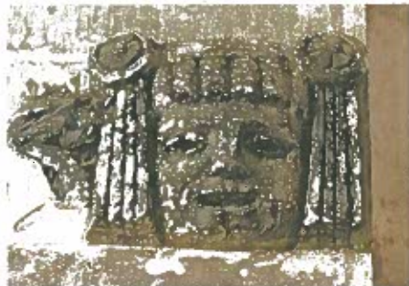
Jugendstil Stuck säumte einst die Wände. Erhaltene Teile werden nun gesichert
