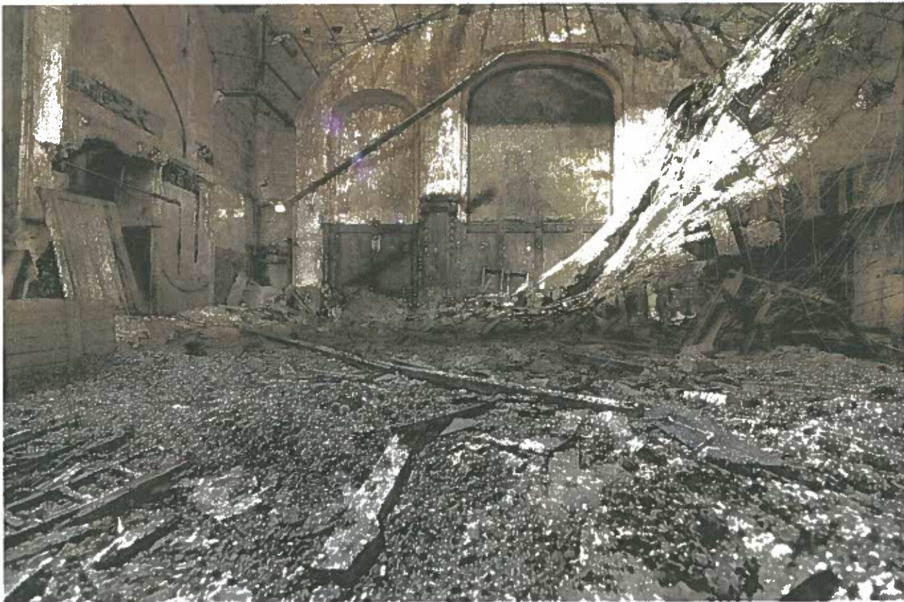
Ruine Die Gewölbedecke eingestürzt, dazu Schutt aus Jahrzehnten: So sah der Varietésaal aus, als Dirk Moritz ihn entdeckte
